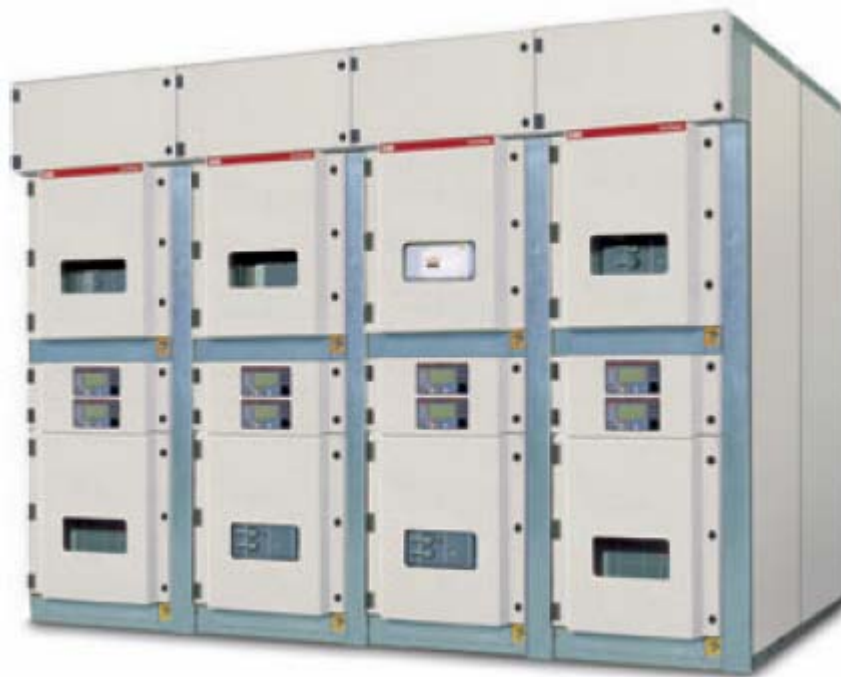
Obr. 2.10. Vnútorná skriňová rozvodňa 22 kV
