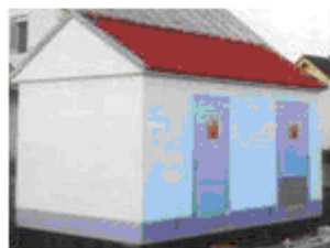
2.12. Kioskové transformačné stanice
